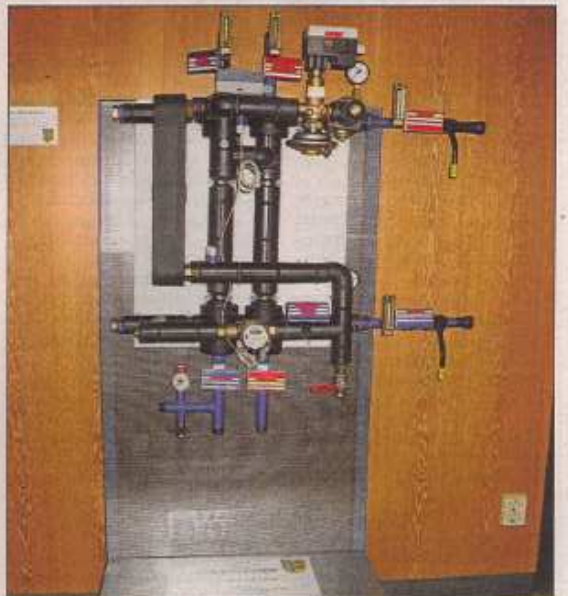
Fernwärmeübergabestation mit circa 15 kW.
