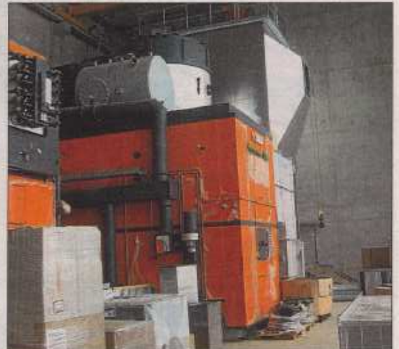
Biomassekessel 1 mit nebenstehendem Thermoölkessel und Filteranlage.
