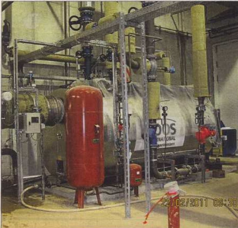
Fossiler Kessel 1 mit circa 4.4 MW Feuerungswärmeleistung.
